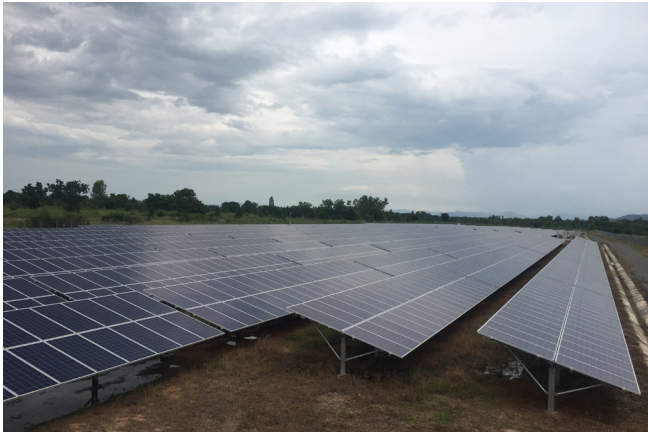
โรงไฟฟ้าพลังงานแสงอาทิตย์ปริมาณพลังงานไฟฟ้าเสนอขายตาม สัญญาซื้อขายไฟฟ้า 2.0 เมกะวัตต์
