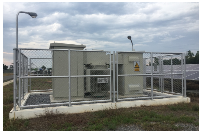
หม้อแปลงไฟฟ้า (Transformer)
