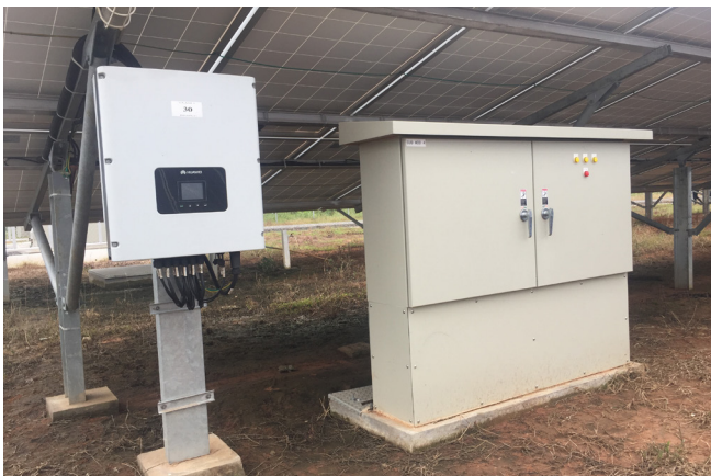
เครื่องแปลงกระแสไฟฟ้า (Inverter) / DC Combiner Box
