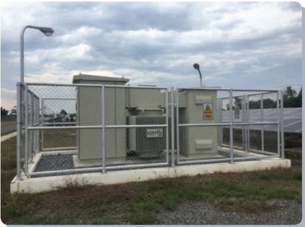
หม้อแปลงไฟฟ้า (Transformer)
